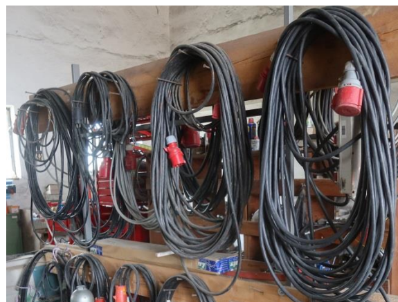
Elektrokabel müssen jährlich auf „ordnungsgemäßen Zustand“ geprüft werden.
